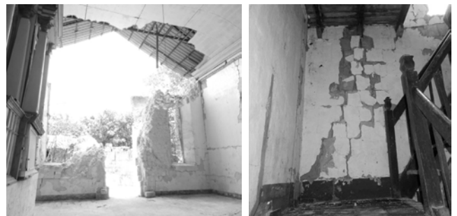
(e) 北壁面の崩落
