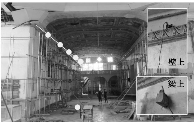
写真3 センサー設置位置 (○箇所)
